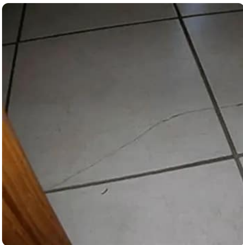
Exemple carrelage fissuré
