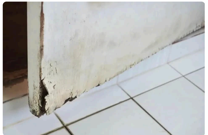
Meuble qui a pris l'eau : à remplacer
