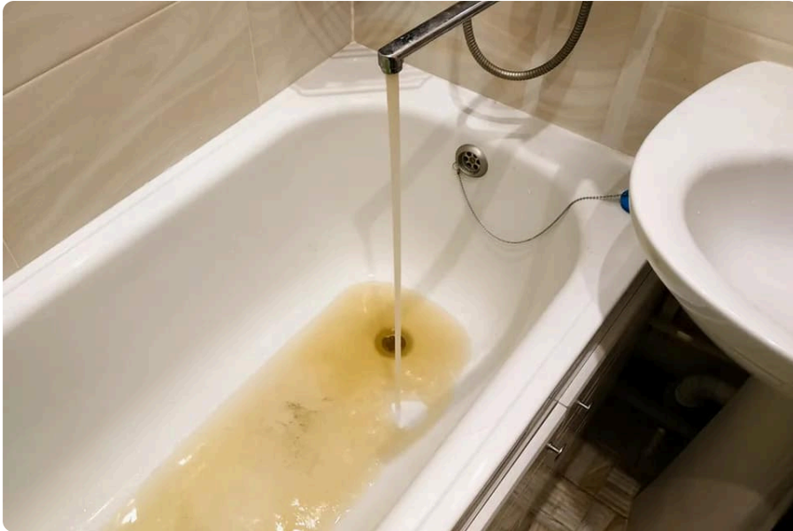
Eau rougeâtre = rouille dans les conduites ⚠️
