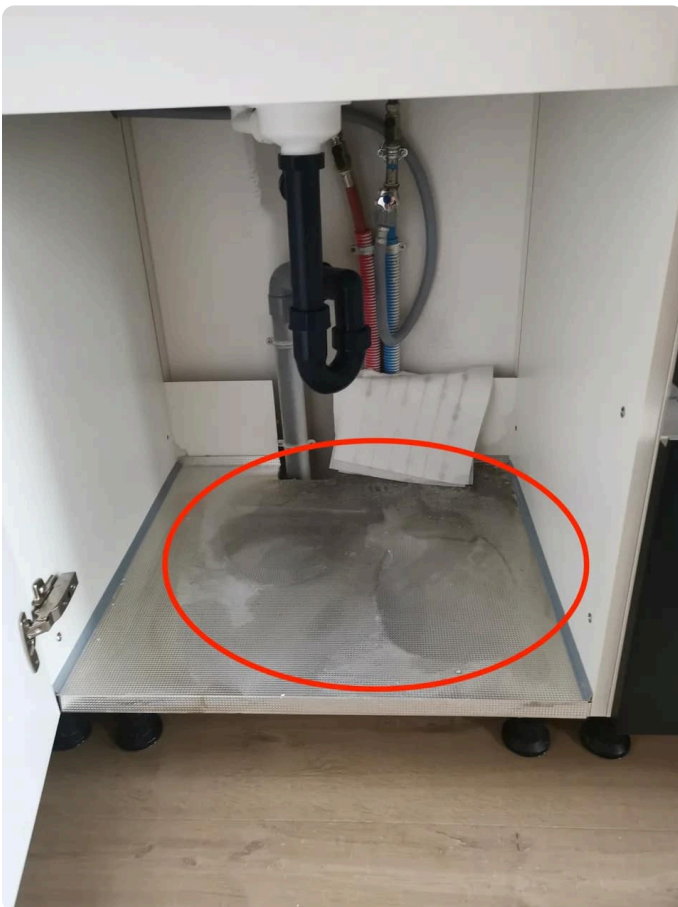
Fuite sous siphon
