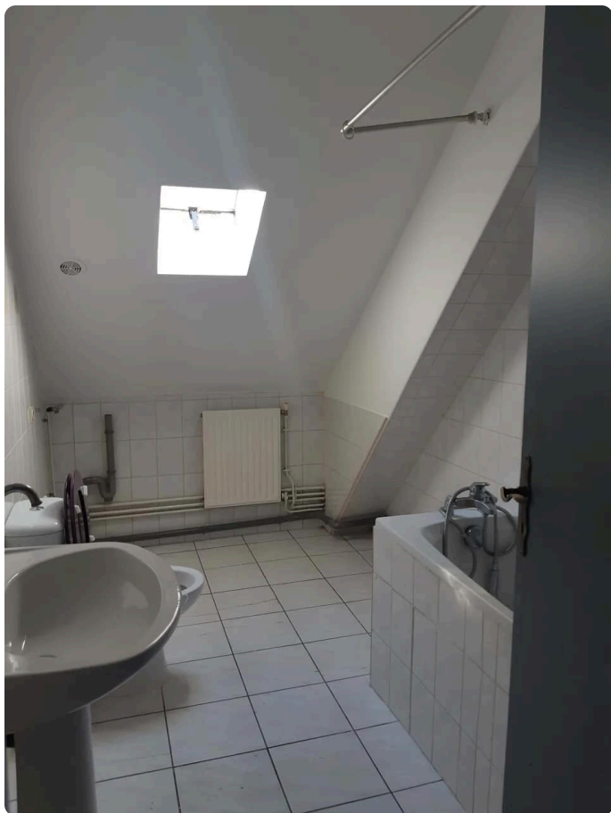
État initial (on remarque que le carrelage est fissuré à certains endroits)
