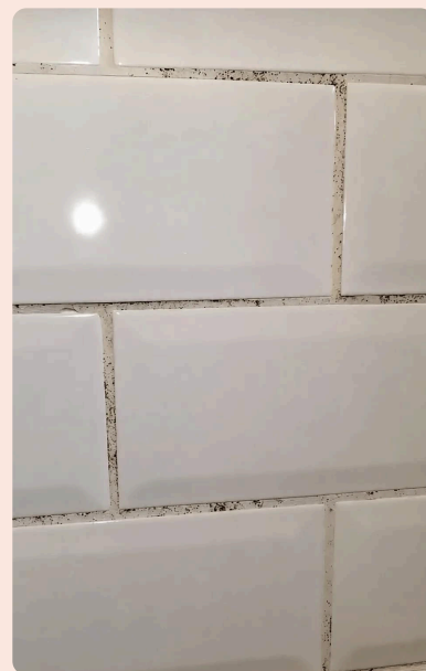
Exemple joints encrassés
