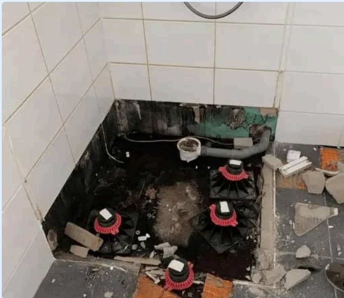
BA13 gorgé d'eau - exemple de dégâts
