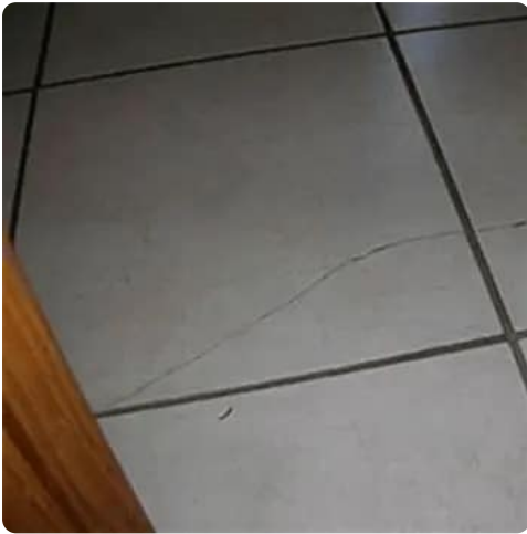
Exemple carrelage fissuré
