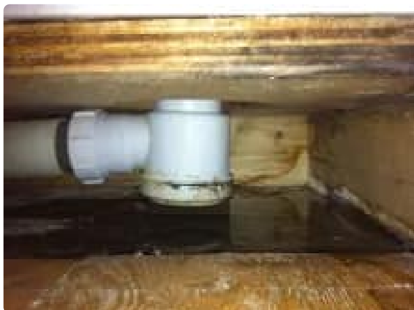
Exemple bonde qui fuit. Source : Consobrico
