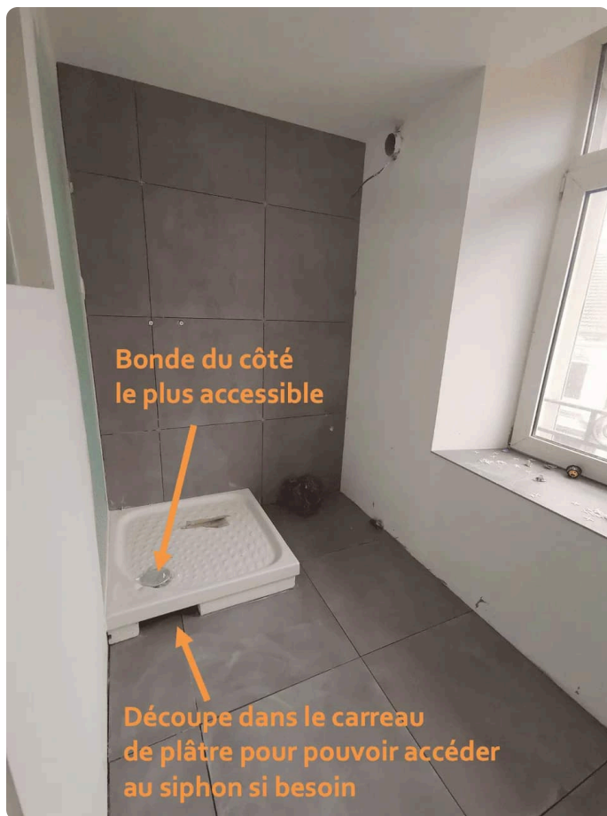
Exemple « avant » : création d'une trappe pour accéder à la bonde
