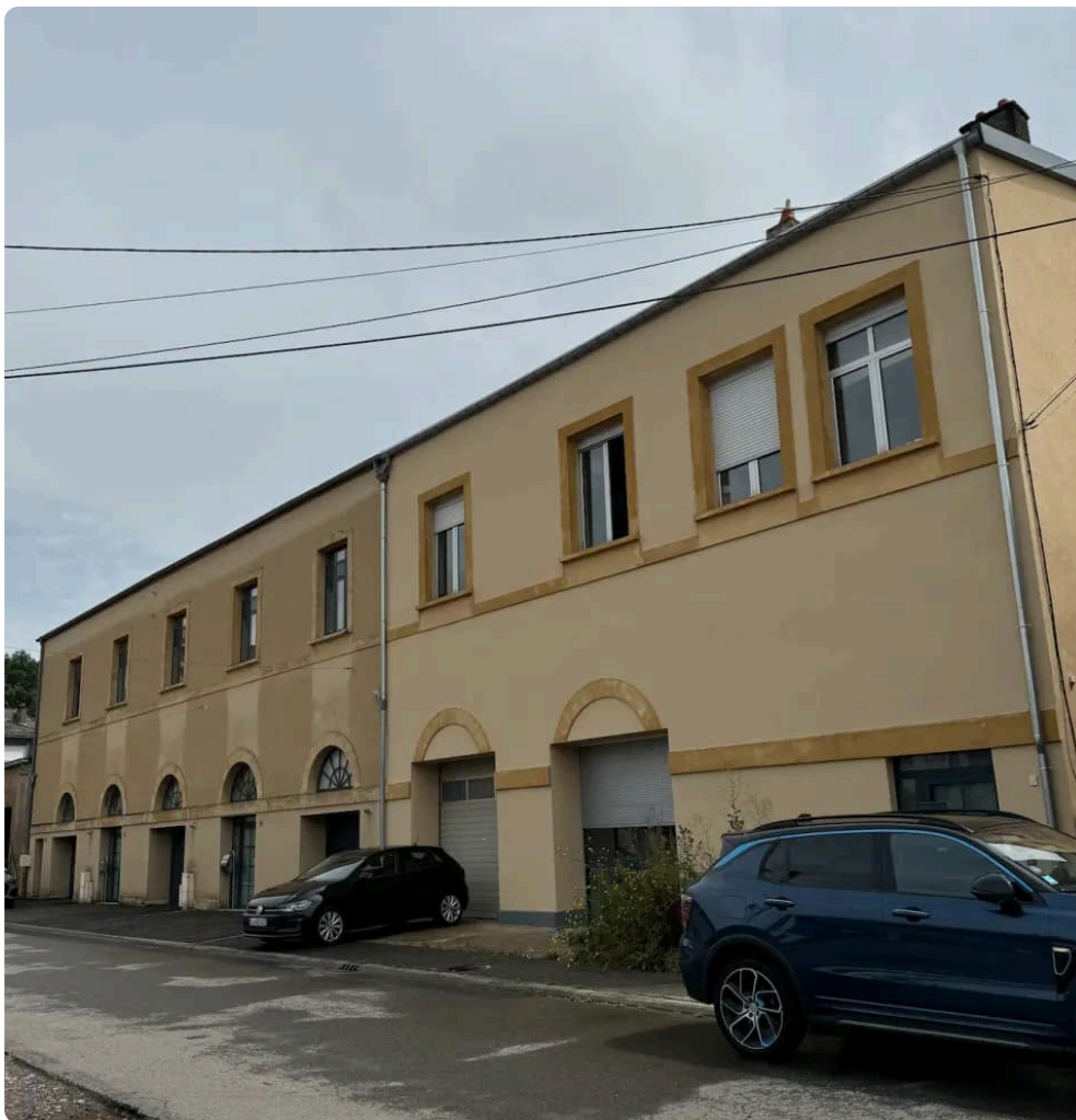
À droite, l'eau glisse sur le crépi siliconé ; à gauche, le crépi minéral reste humide
