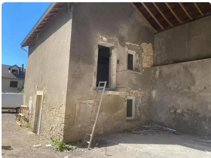
Avant : enduit ciment soufflé
