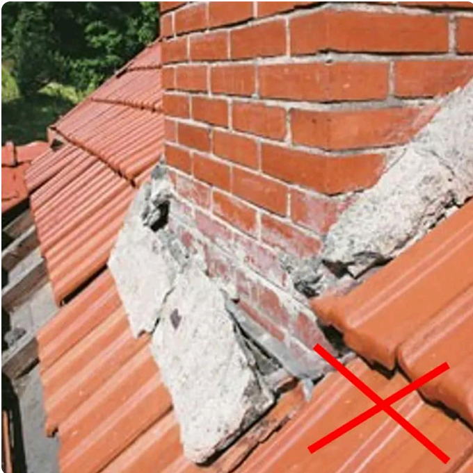
Étanchéité au mortier à reprendre
