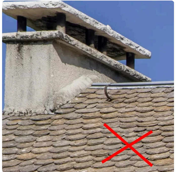
Étanchéité au mortier à reprendre
