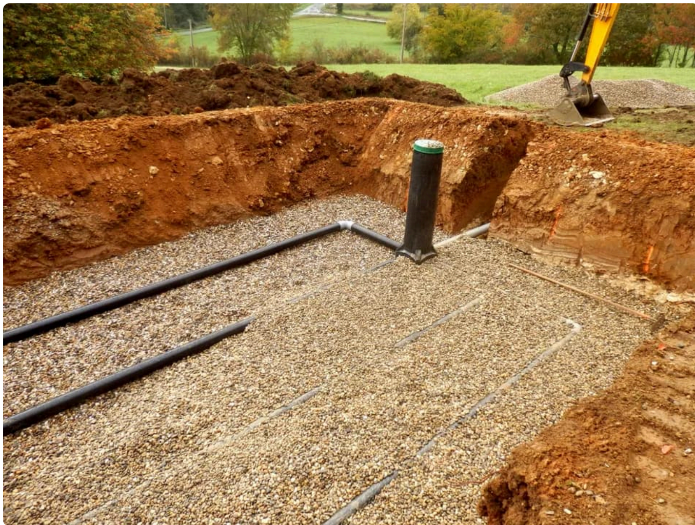
Figure 3 : conduites perforées répandant l'eau en aval du prétraitement par la fosse septique
