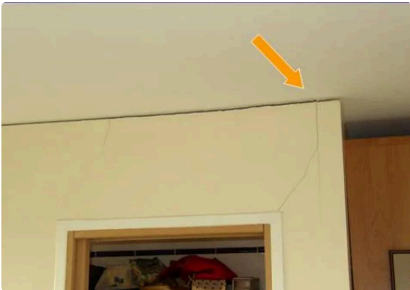
Pathologie d'un plancher qui a fléchi
